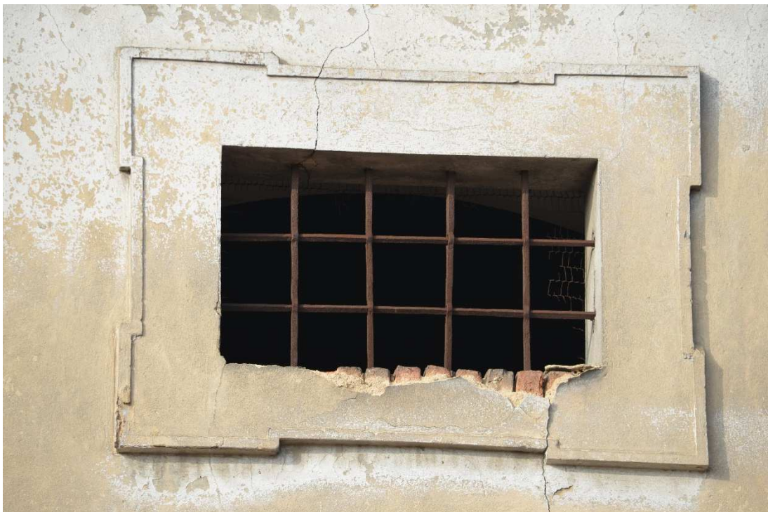
41. Východní fasáda, jižní osa druhého patra, detail okna s dochovanou šambránou.
