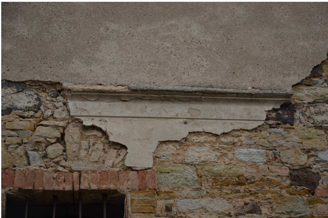
35. Západní fasáda, detail fragmentu římsy mezi prvním a druhým patrem. Nad římsou mladší omítka, přetažená přes starší profil.
