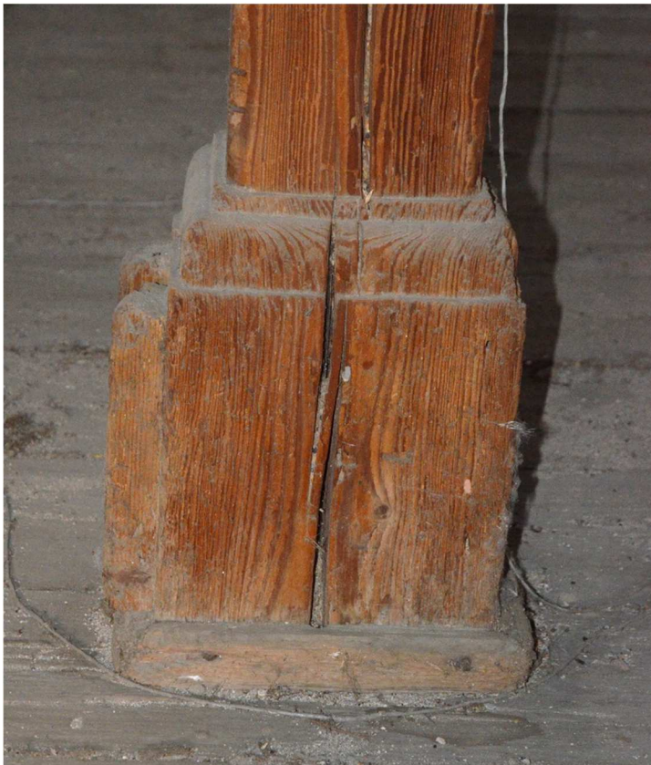
84. Druhé patro, pozdně barokní sloup středního průvltaku, detail patky. Na boku je lačková drážka pro vložení přepážky.
