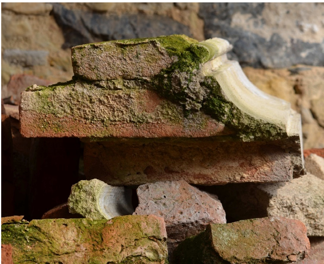
24. Část profilu hlavní římsy nad římsovou deskou, zřícený fragment.
