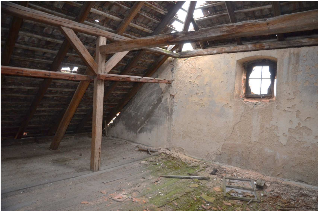
94. Krov, jz. nároží, v omítce štítu otisk starší konstrukce. Ve špaletě okna fragment starší dřevěné výplně.
