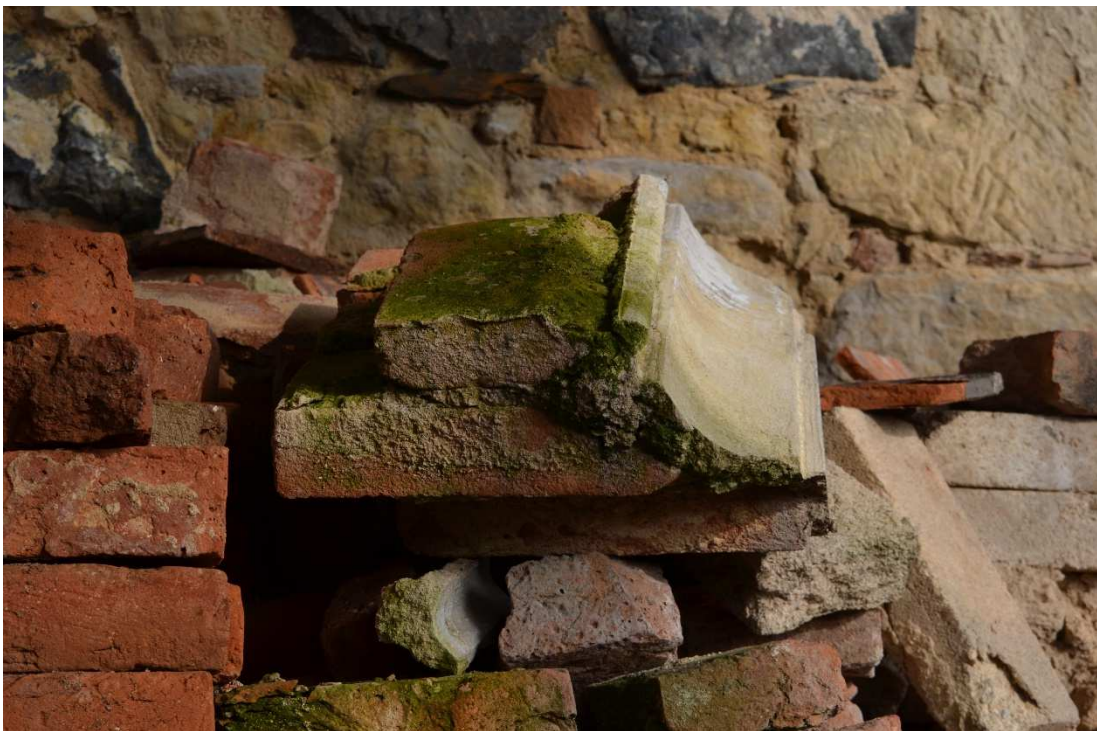
23. Část profilu hlavní římsy nad římsovou deskou, zřícený fragment.
