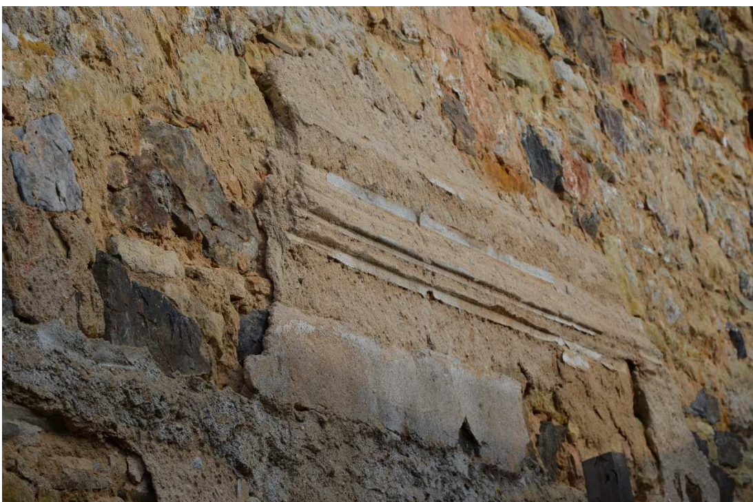
25. Jižní fasáda, detail poškozené římsy mezi přízemím a prvním patrem.
