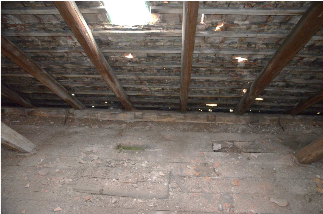
93. Krov, detail nastavení severní pozednice s prázdnými dlaby.
