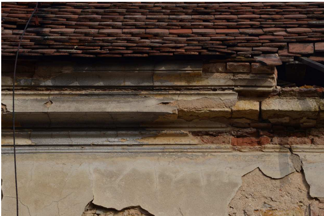
21. Jižní fasáda, detail narušené hlavní římsy s pozůstatky mladšího šedého nátěru.
